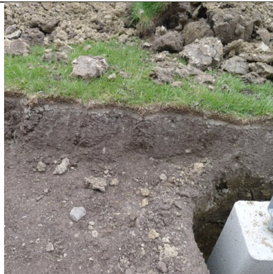
Bild 24. Underjorden får inte vara packningsskadad och anläggningsjorden ska vara min 5 cm. Vid kontroll där marken var uppgrävd noterades att underjorden var hårt packad samt att anläggningsjorden varierade mellan obefintligt till maximalt 2 cm.
