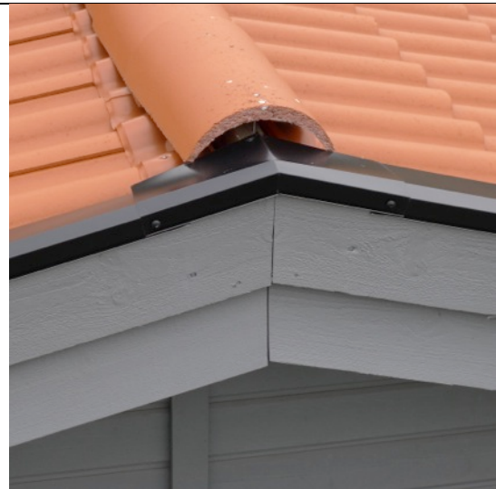
Bild 6. Öppning mellan vindskiva och nockpanna. Gavel hus nr 9-15.
