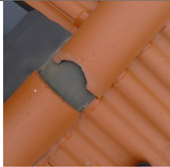
Bild 4. Skadad nockpanna ej fastsatt. Beteshagen 2-7
