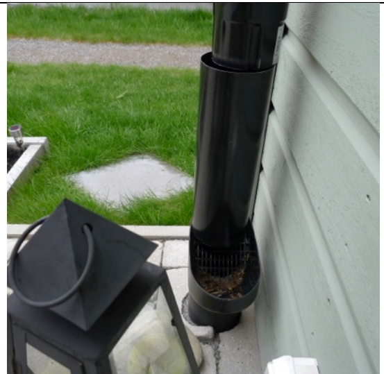
Bild 22. Stuprör är för kort, öppning finns mellan lövrens och stuprör.
