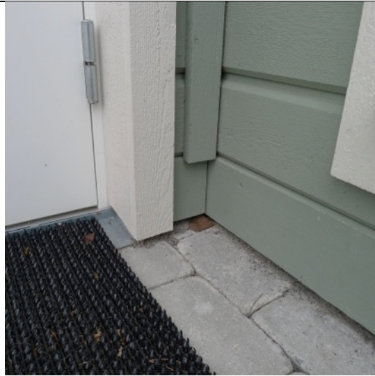
Bild 15. List i vāghörn är felaktigt avslutad i förhållande till panel. Panelen bör ha ett större uppdrag från mark.
