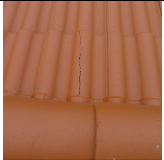
Bild 8. Spräckt takpanna, det förekom flera skadade pannor.
