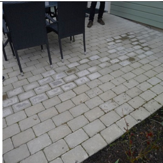
Bild 26. Uppträngning av vatten sker vid nr 15. Sannolikt behöver dräneringen av ytan justeras/förändras.
