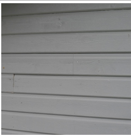
Bild 11. Panelbrädor spräckta vid skarv, sannolikt har man inte förborrat vid spikning närmre än 150 mm från virkesände. Skarvar i intilliggande bräder skall förskjutas minst 600 mm.
