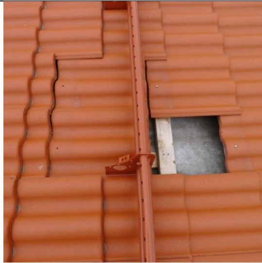
Bild 3. Takpanna saknas, öppning i taktäckning fanns vid besiktningstillfället, Beteshagen 2-7. Takpannorna var ej fastsatta enligt Benders anvisningar.
