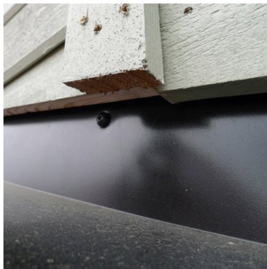
Bild 17. Ändrä på lockläkt och avslutning på panelbräda är omålade, generellt fel.
